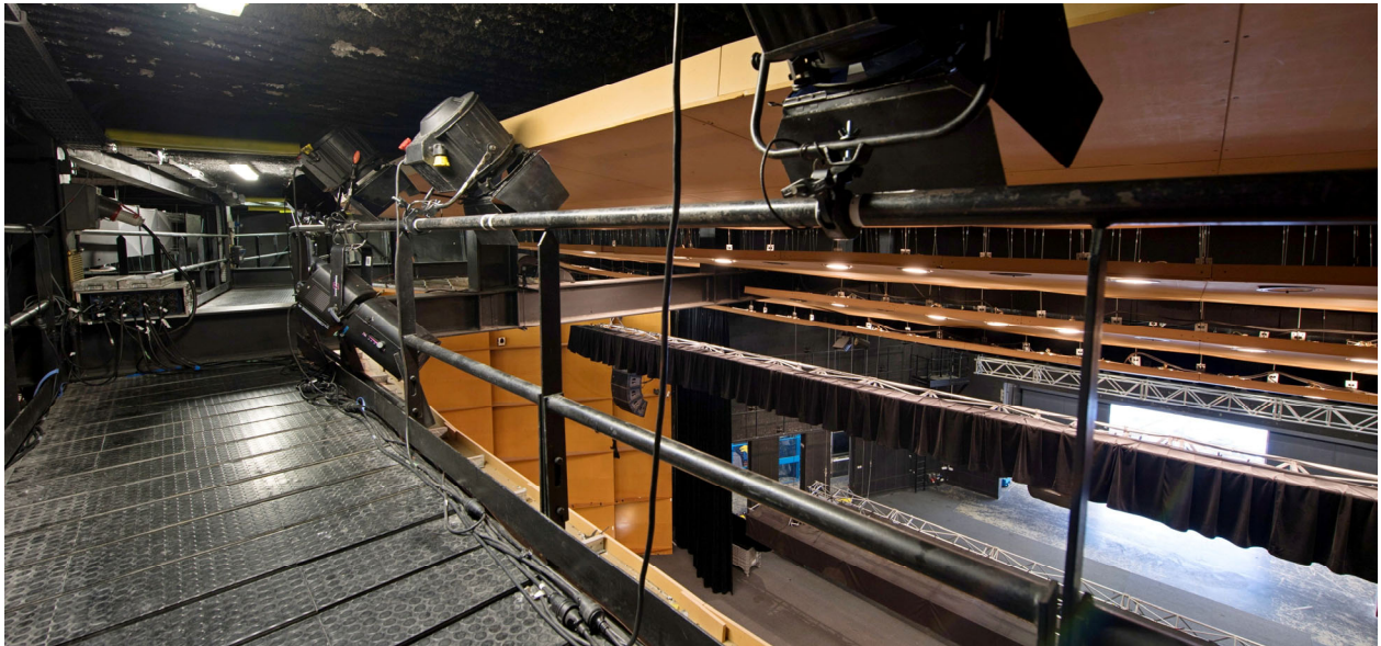
Lisses inférieures passerelle B en position basse pour installation découpes Lower guardrails catwalk B in lower position for profile projectors
